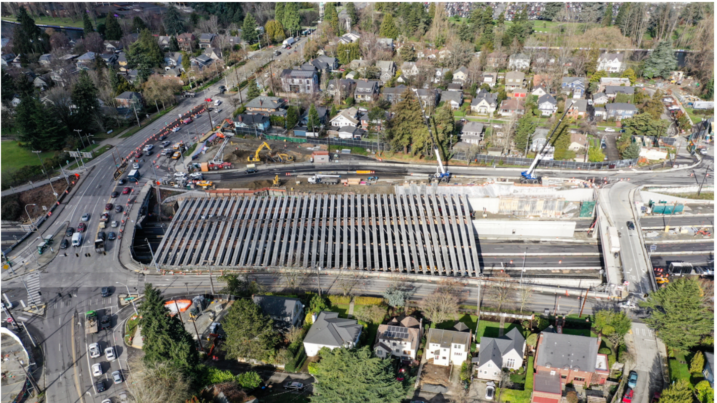
Вид сверху на бетонные балки, которые были установлены над внутриштатным шоссе SR 520, образуя фундамент перекрытия, которое напоминает по своей форме плоскую крышку. Шоссе проходит рядом с жилым районом, а слева от балок расположена крупная городская улица.
