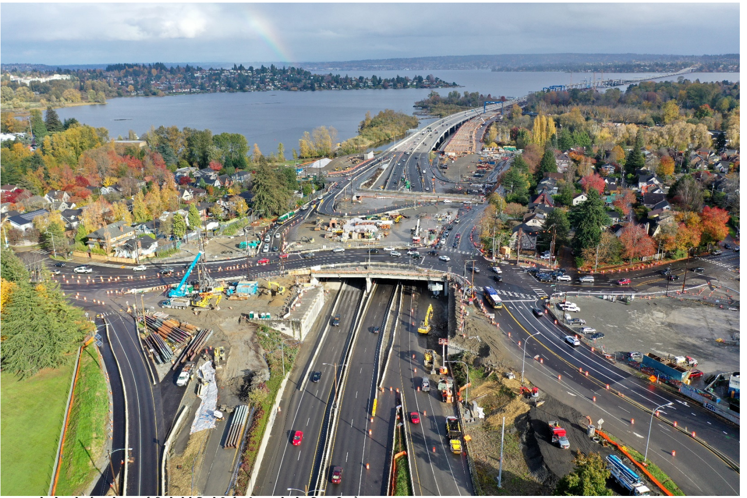
SR 520/मोन्टलेक बुलेवार्ड इंटरचेंज पर पूर्व की ओर देखें जिसमें निर्माणाधीन नया मोन्टलेक लिड शामिल है।
